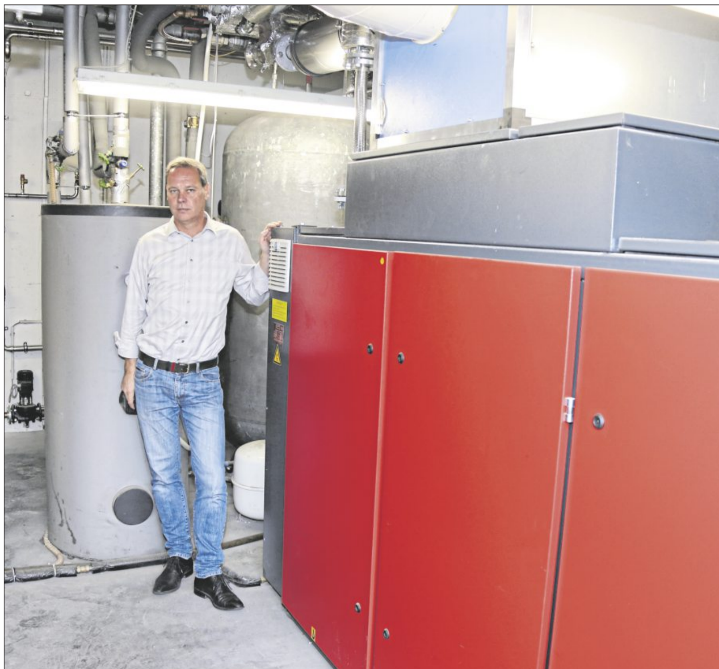
Martin Wennberg zeigt das Block-Heizkraftwerk, das Druckluft erzeugt.
